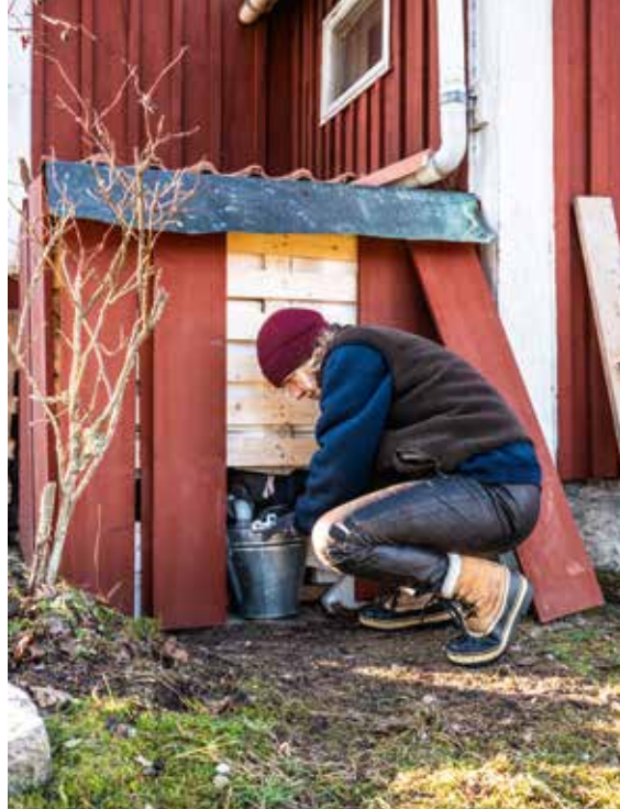
Forklædt bag rødmaledede brædder og tegltag gemmer sig den ene af Alethas to regnvands-beholdere. Vandet bruges til toiletskyl.
